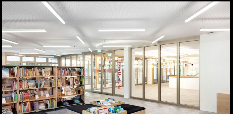
Bibliothek: „Quadro“-Pendelleuchte mit seitlicher Spezialabdeckung aus Acrylglas opal mit Mikroprismen sowie eingelegter Folie am Leuchtenboden.
